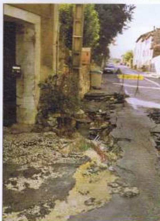
Quelques dégâts "sans trop de gravité".
