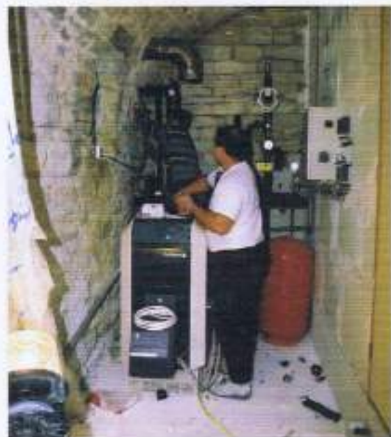
Et voilà la nouvelle chaudière
