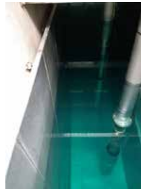
Le réservoir de Salavas en inox tout neuf
